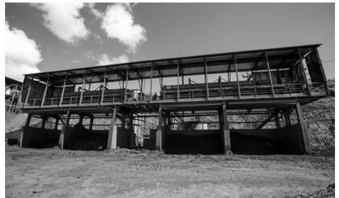
L'installation de filtres-presses
