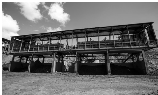
L'installation de filtres-presses
